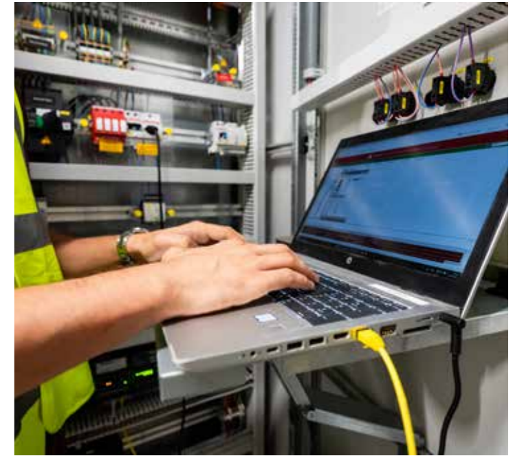
Die aktuelle GA-Hauptarbeit: Datenpunkttests und Linienprüfungen in der Raumautomation.
