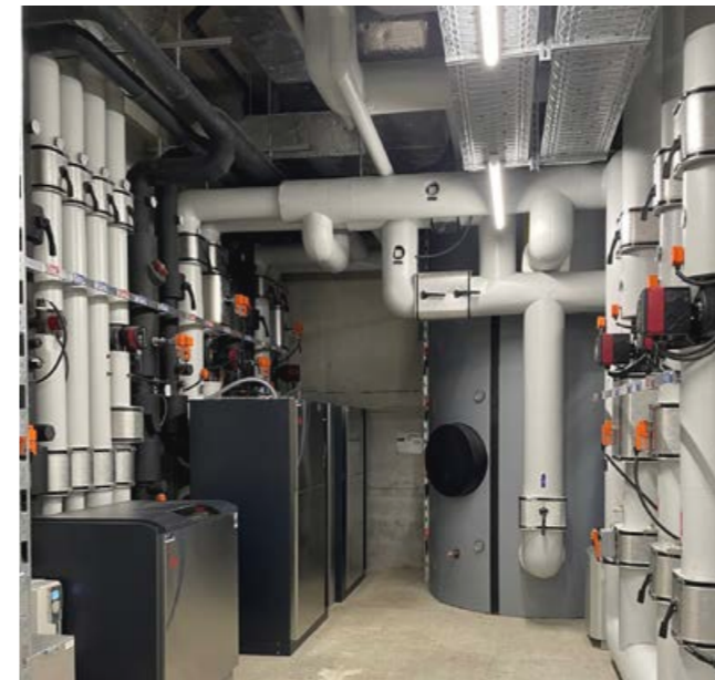
Die GA fokussiert sich im neuen Schulhaus auf die HLKS-Systeme.
